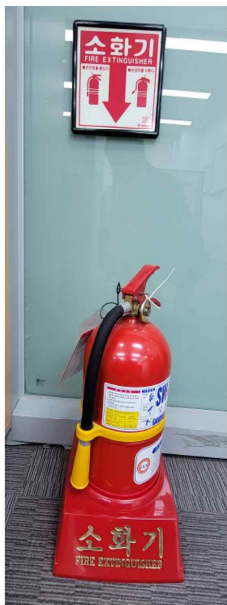
<소화기 정상설치 사진>
